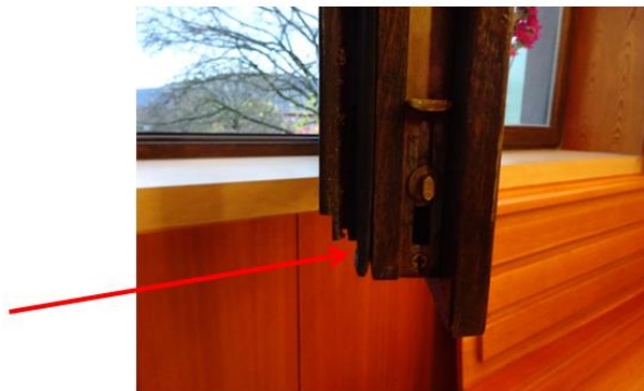
Abbildung 8: Schwachstellenanalyse Margarethenhalle: Fensterdichtungen
