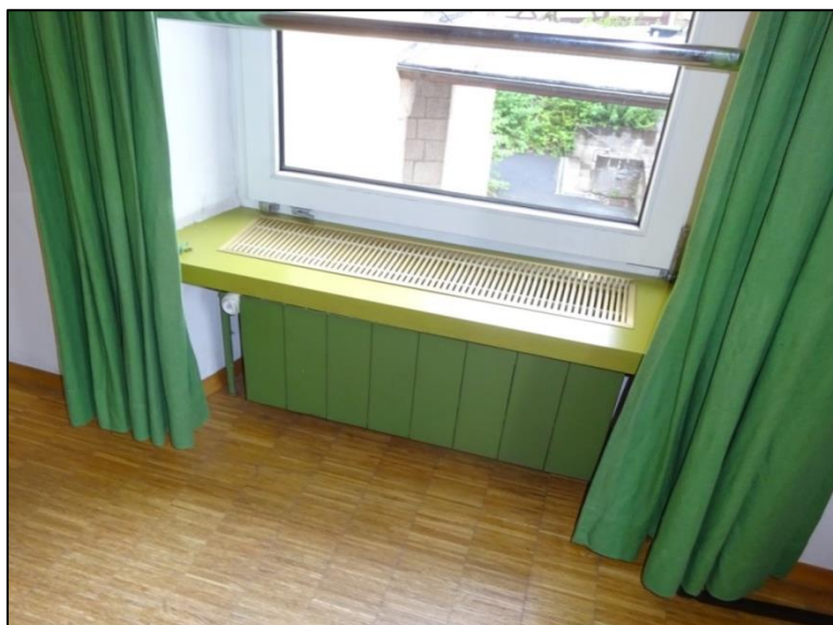
Abbildung 7: Schwachstellenanalyse Rathaus: Heizkörpernischen
