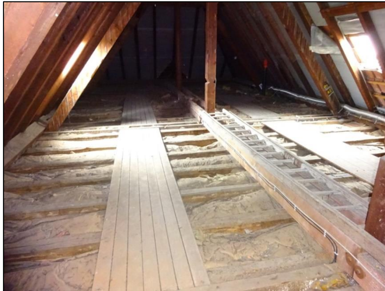
Abbildung 6: Schwachstellenanalyse Rathaus: Oberste Geschossdecke
